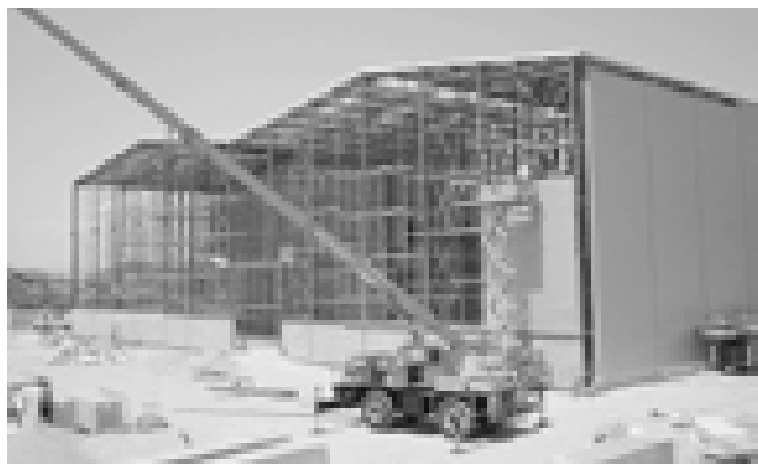
Silokonstruktion aus ELVEDI-Freitrag- und Palettenregalen
