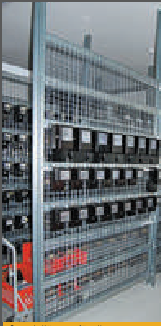
Speziallösung für die ZEAG Energie AG
